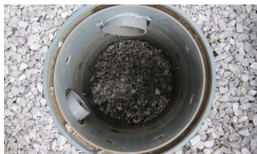
雨水浸透ます
