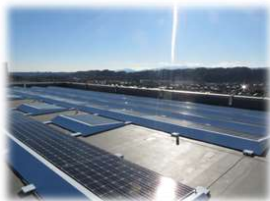
市役所屋上の太陽光発電システム
