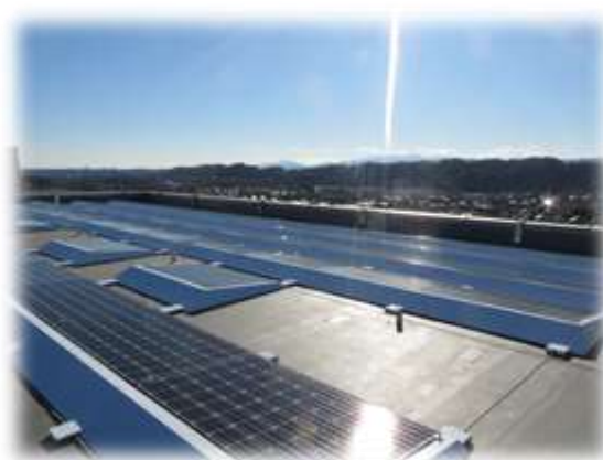
市役所屋上の太陽光発電システム 平成 27 年 12 月より稼働しています。
