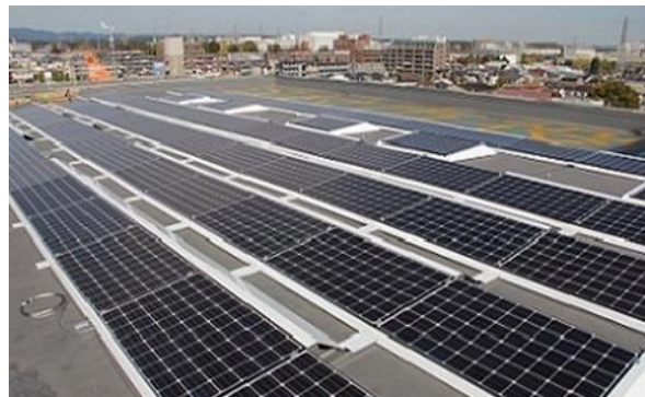
羽村市役所庁舎屋上に設置してある太陽光発電設備
