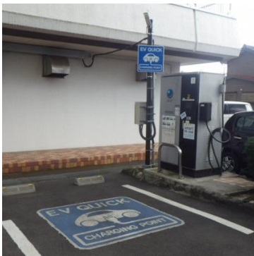
羽村市役所に設置してある電気自動車の急速充電設備
