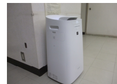
空気清浄機の設置
