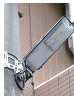
より効率の良い照明になった街路灯
