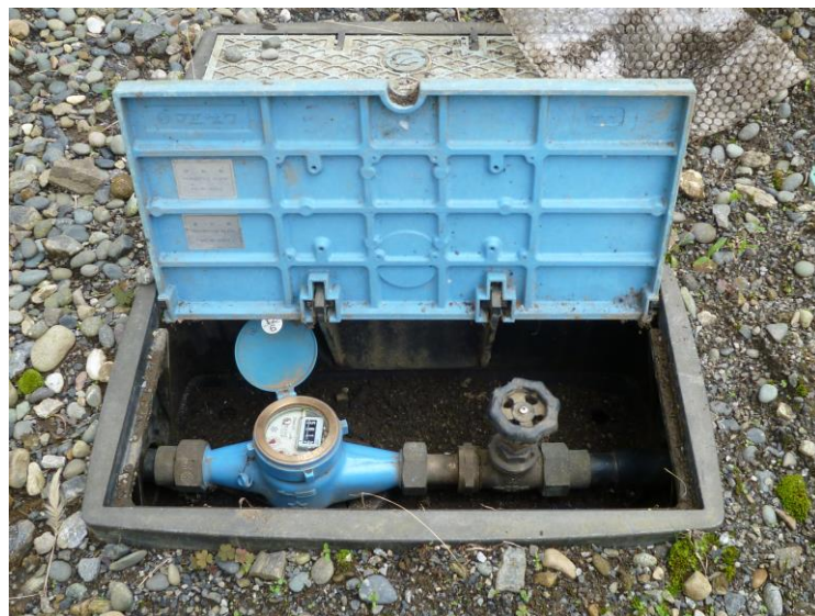
【水道メーター】
