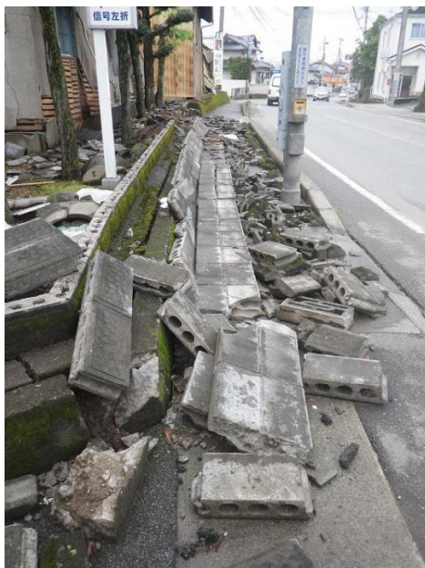
倒壊したブロック塀
