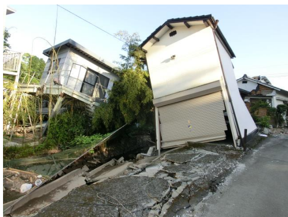
熊本地震（熊本県益城町）
