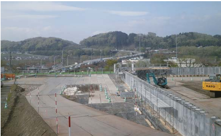
箱根ヶ崎駅西口から羽村市内を通過し、あきる野市方面に至る「都市計画道路3・4・12号線」の早期整備に向けて、羽村大橋東詰交差点付近において擁壁工事を行っています。
