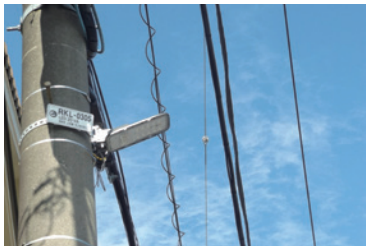
LED化した街路灯
