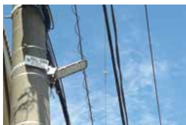
LED化した街路灯
