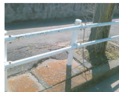
街路樹の根上がりで歩きづらい歩道
