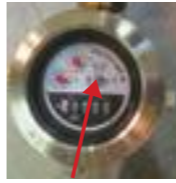
水道を使っていないときにメーターのここが回っていたら要注意
