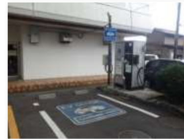
◀市役所駐車場に設置している電気自動車用急速充電器
