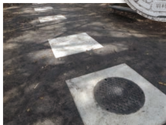
災害用マンホールトイレ（あかしあ児童公園）
