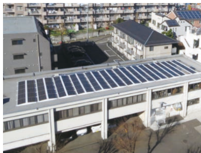
市役所西分室屋上の太陽光発電
