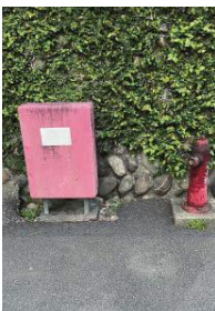
老朽化した消火栓
