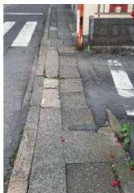
劣化した歩道
