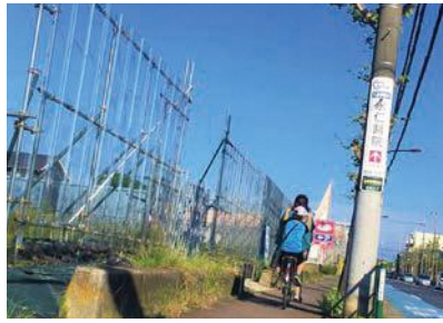
高さ3メートルのフェンスに囲まれた新奥多摩街道沿いの残土置き場
