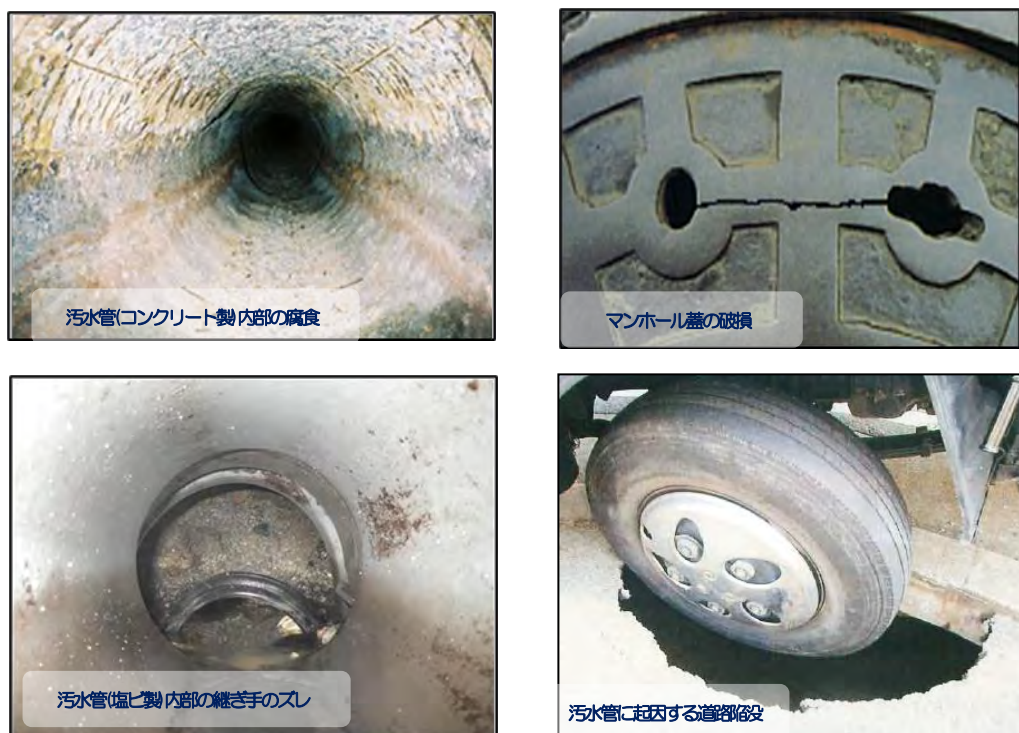
図 3-8 下水道管路の破損例
