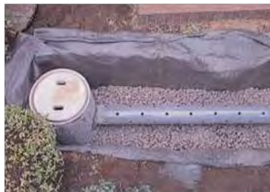
雨水浸透トレンチ管
