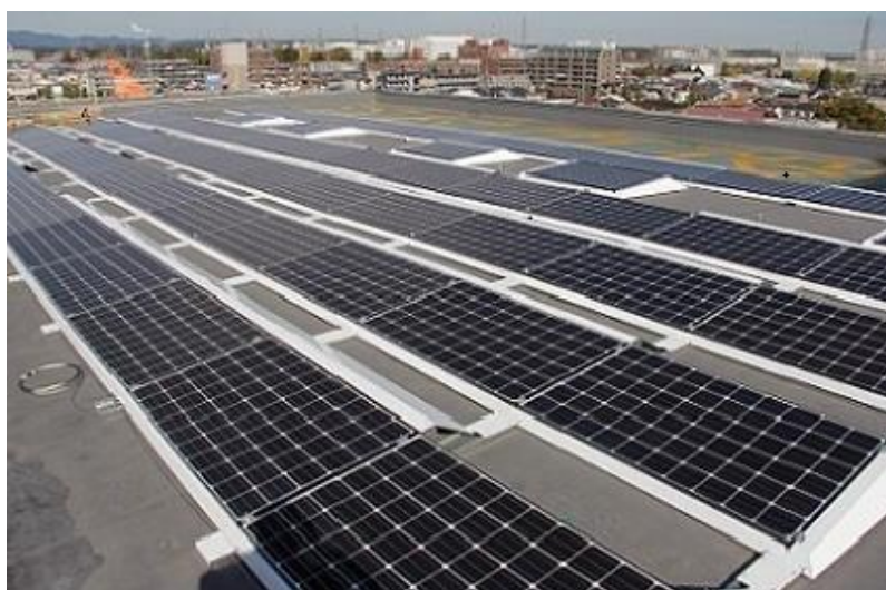
市役所庁舎屋上の太陽光パネル
