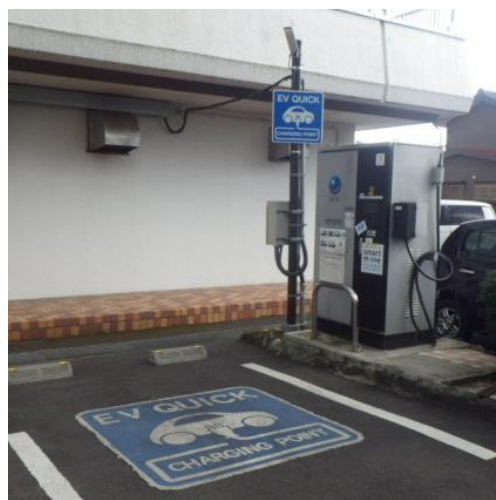
市役所駐車場の急速充電器
