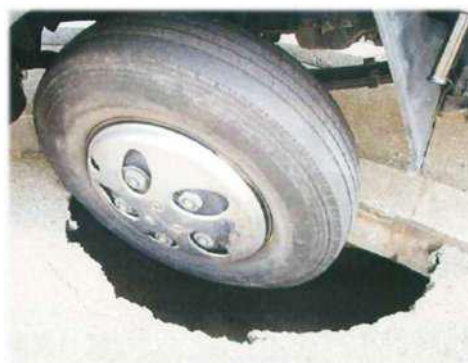
汚水管に起因する道路陥没
