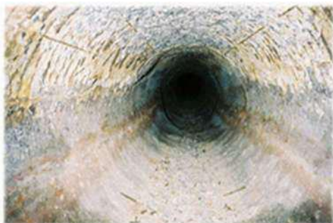
汚水管(コンクリート製)内部の腐食
