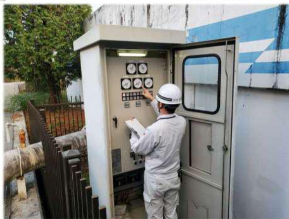
写真 5-28 技術職員による那賀樋管ゲート操作訓練及び、雨水排水ポンプ操作訓練
