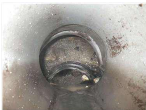
汚水管(塩ビ製)内部の継ぎ手のズレ
