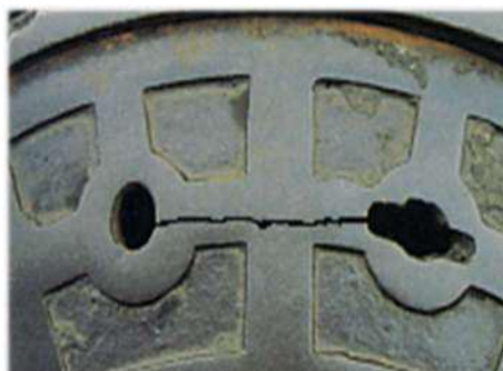
マンホール蓋の破損
