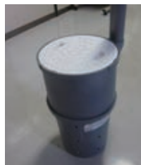
▲雨水浸透ます
