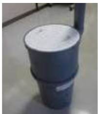
▲雨水浸透ます
