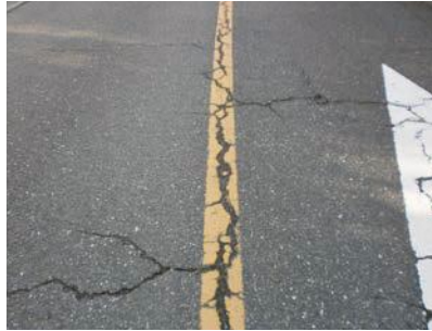
舗装状況が劣化している市道
