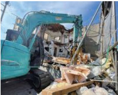
家屋の取り壊しが続いている
