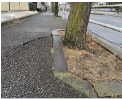
街路樹による歩道の根上がり
