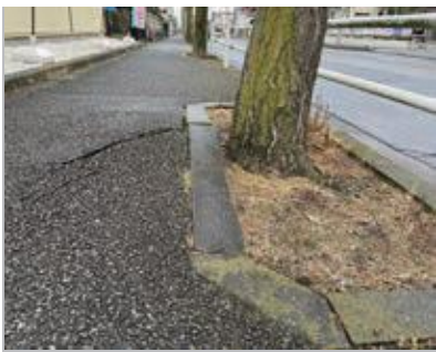
街路樹による歩道の根上がり
