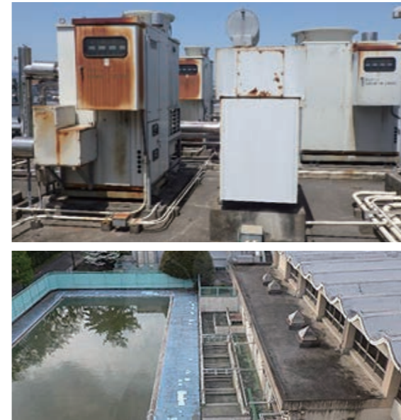
建設から年数が経ち、市内の公共施設の老朽化が目立ちます
