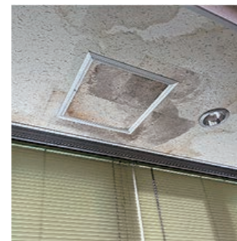
繰り返す雨漏りがシミになった天井も…
