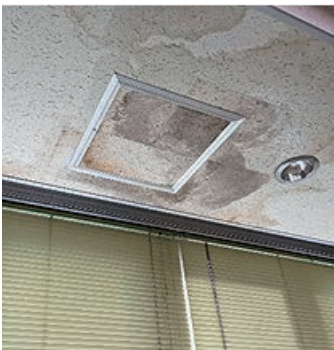
繰り返す雨漏りがシミになった天井も…
