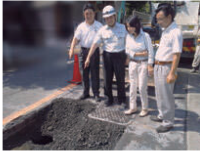
平成26年に市道の路面下空洞調査を実施した際に空洞が発見された現場
