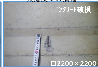
緊急度Ⅰの損傷
