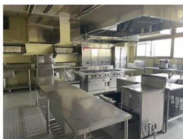
旧厨房（約 55 ㎡） ※業務用ガスコンロを設置。
